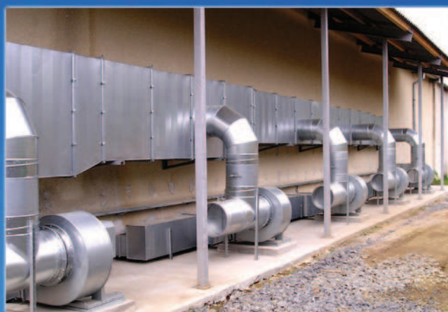
Ventilátory provětrávacího systému
